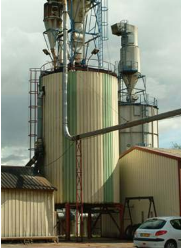
Stockage des sciures qui alimente une chaudière pour sécher le bois et chauffer l'usine. (Crédit photo Jean-Paul Houdry/ADEME)
